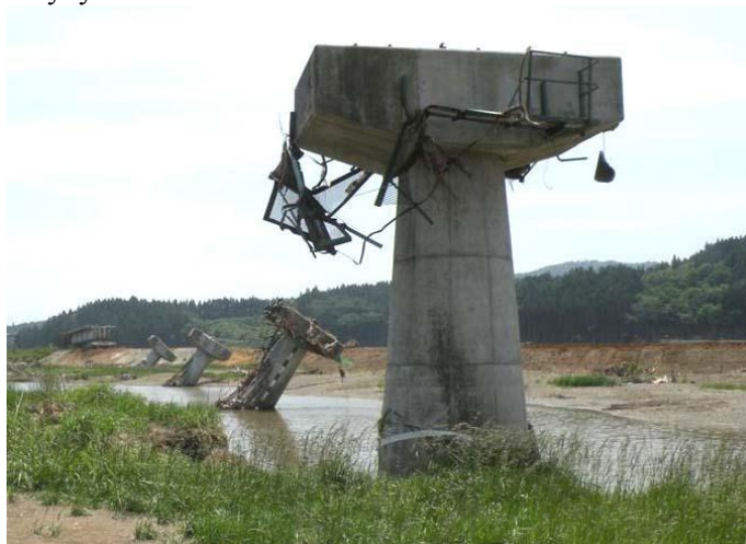
Рис. 5. Опрокидывание трех опор виадука в Койзуми-о-Хаши при землетрясении в марте 2011 г. в Фукусиме
