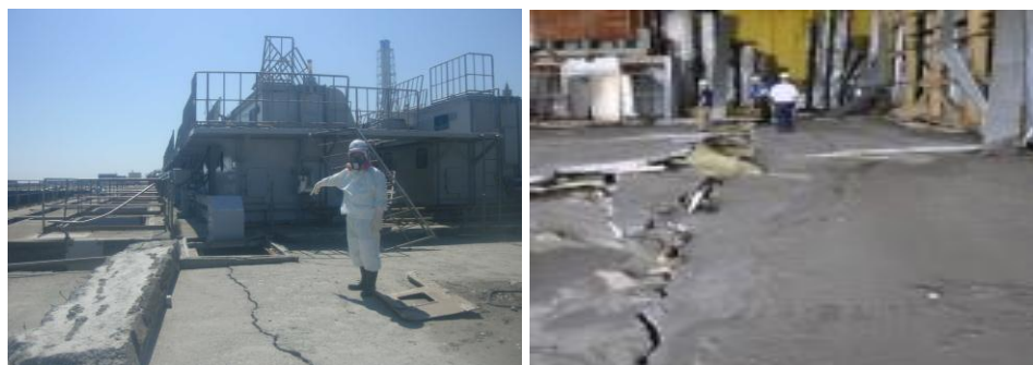
Рис.2. Разрушения фундаментных плит, вызванные землетрясением в Японии в марте 2011 г.
